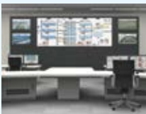
上下水道プラントシステム
