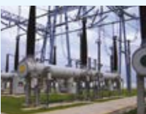
ガス絶縁開閉装置
